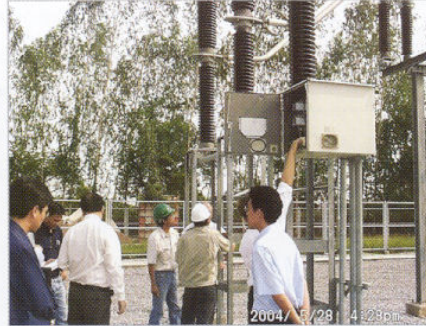
(ซ้าย) สถานีไฟฟ้า 230 kV บางกอกน้อย การไฟฟ้าฝ่ายผลิตแห่งประเทศไทย (ขวา) สถานีไฟฟ้า 115 kV หนองปลิง การไฟฟ้าส่วนภูมิภาค
